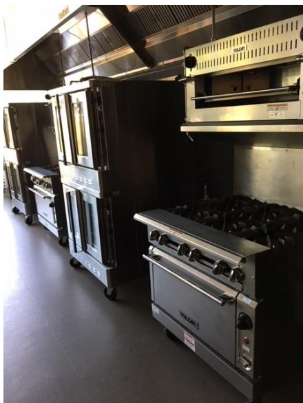
Back Wall Equip
